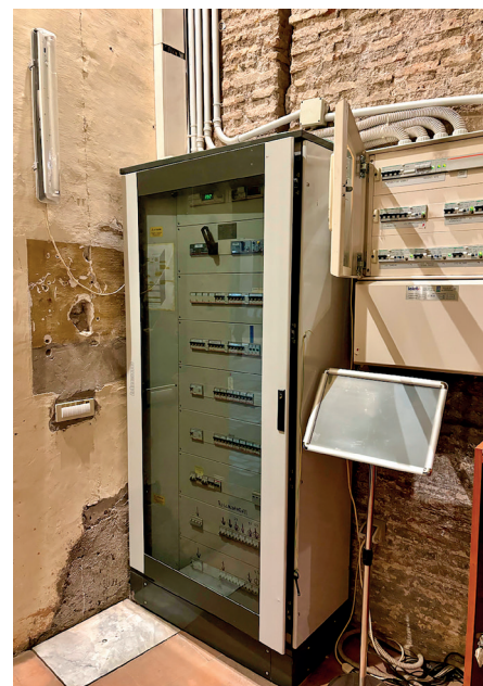
... ebenso die Elektroanlage mit den Leitungen. (Bilder: Dr. Michael Seifert)
